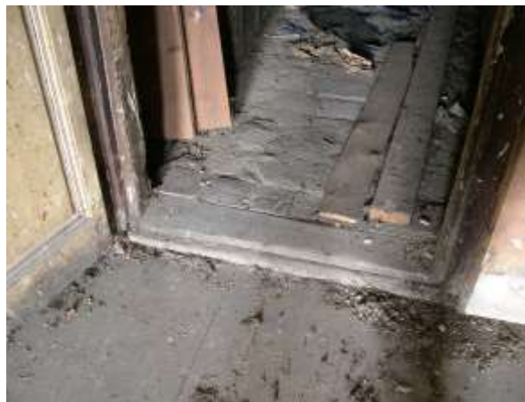
Fig. 26. 2 e étage, pièce principale, différence de sol entre le couloir et la pièce.
