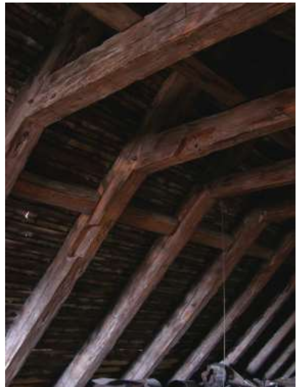
Fig. 38. Combles, trace d'assemblage à mi-bois et assemblage à tenons et mortaises chevillé de l'entrait.
