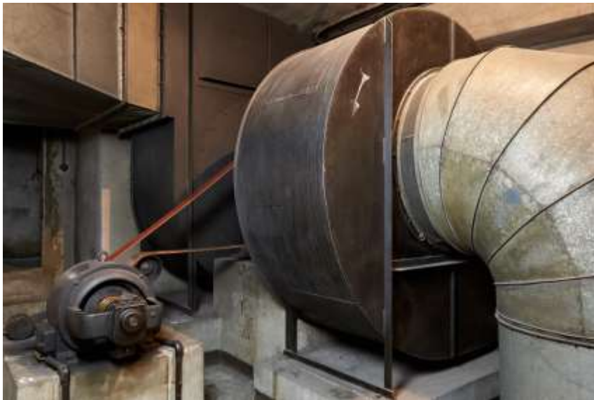
Fig. 86. Sous-sol, machinerie de ventilation.
