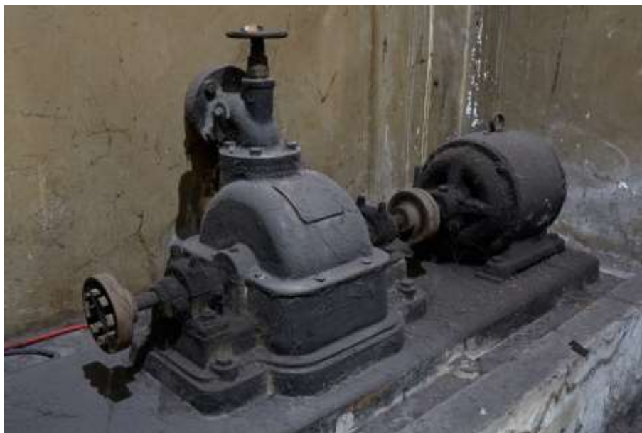
Fig. 20. Génératrice de secours placée dans local situé sous l'escalier extérieur.
