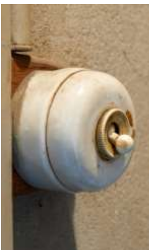
Fig. 94. Annexe, interrupteur électrique.
