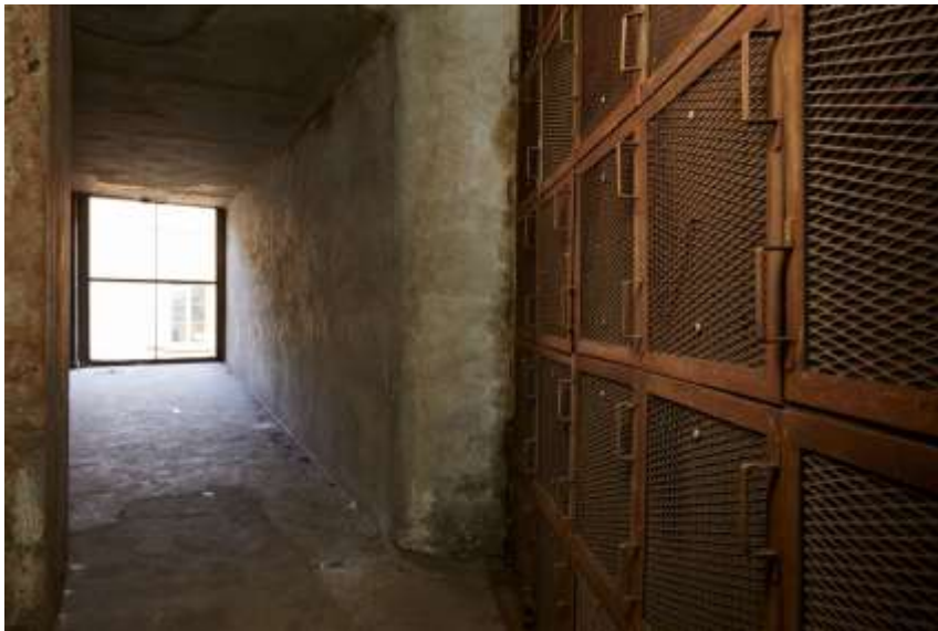
Fig. 84. Sous-sol, prise d'air sur la façade sud.
