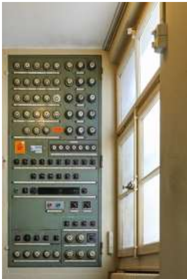
Fig. 79. Tableau électrique au niveau du hall.
