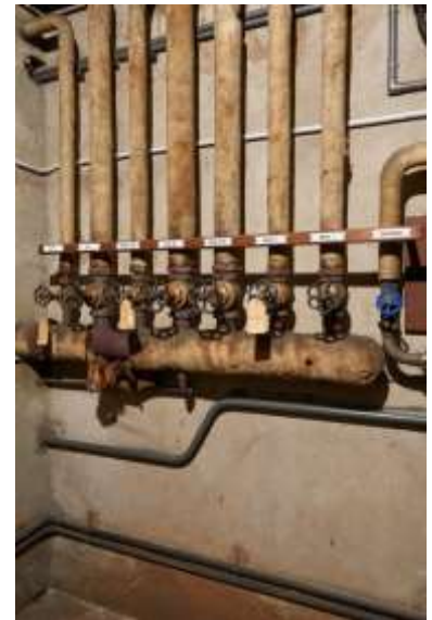
Fig. 87. Commandes pour les différents circuits de chauffage.
