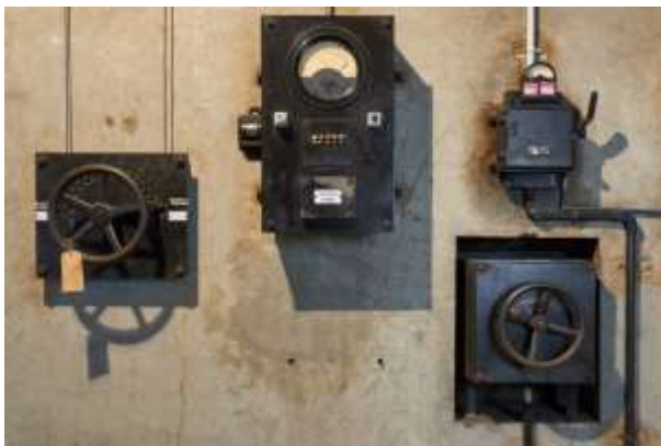
Fig. 88. Sous-sol, commande des machines.
