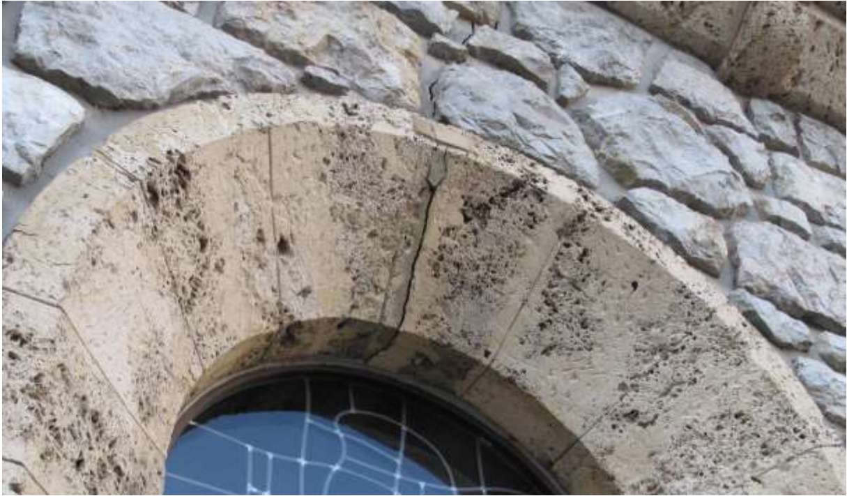
Fig. 75. Fissure sur la façade Est (photo Bruno Corthésy, 2013)
