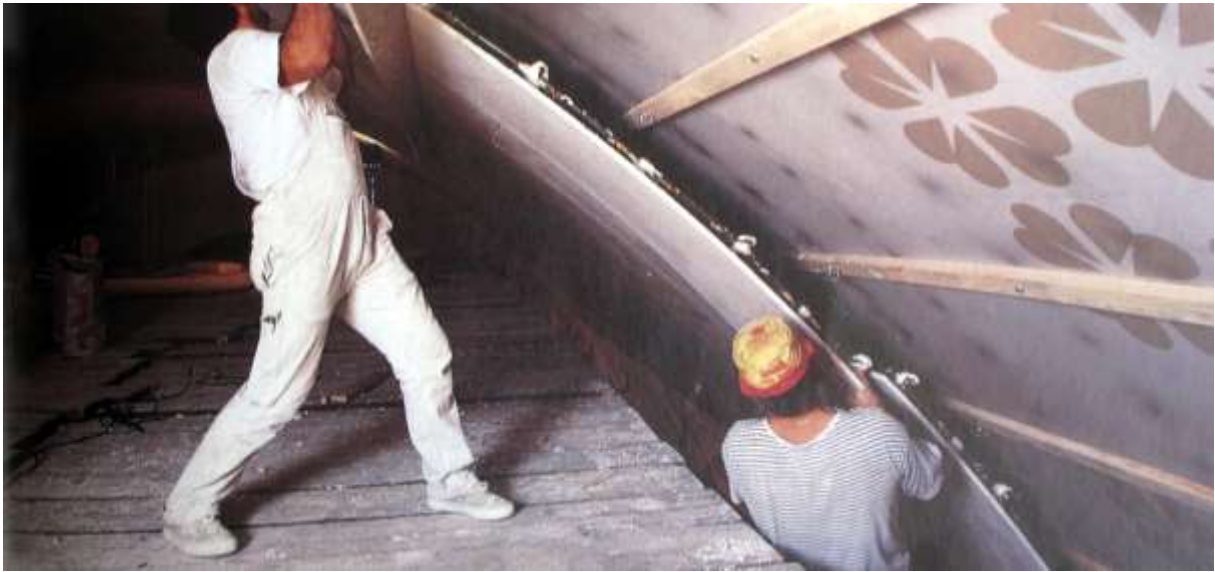
Fig. 68. Pose du faux plafond sur la voûte en 1990. A droite, les décors peints réalisés en 1980 et les taches noires dues à l'humidité (extrait de MONTI, op. cit. ).
