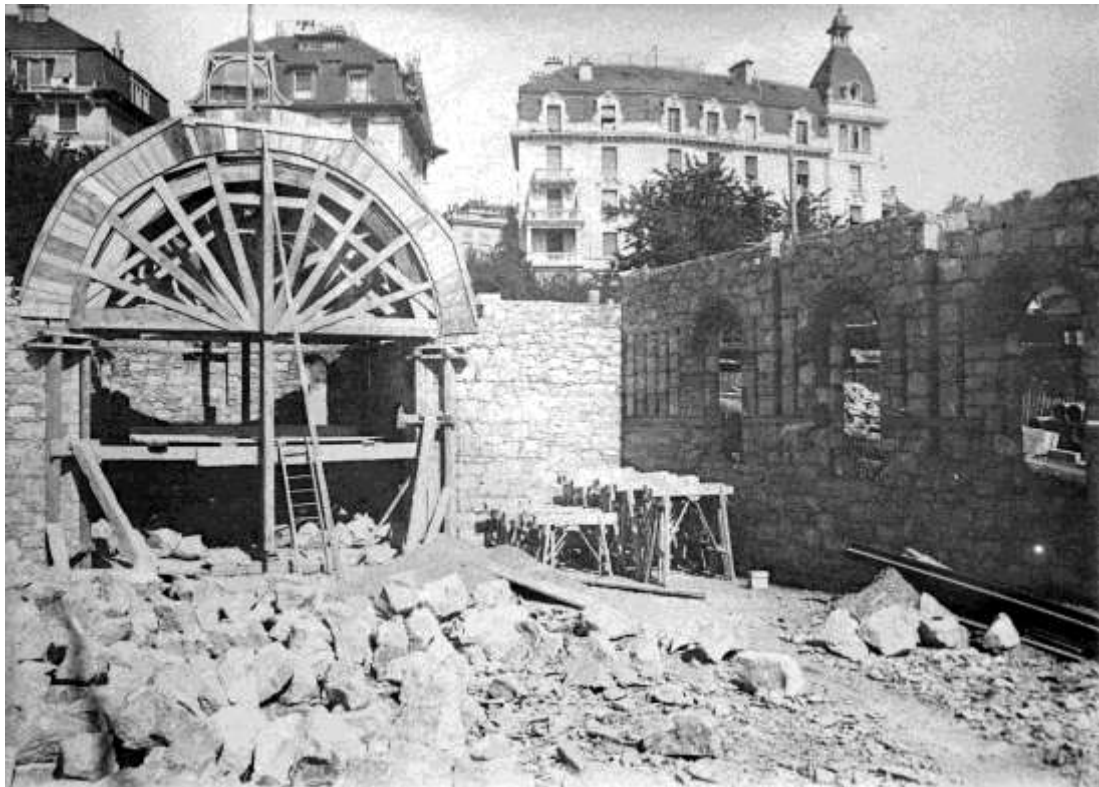
Fig. 10. Chantier de la chapelle du Saint-Rédempteur, septembre 1915 (archives de la paroisse du Saint-Rédempteur).
