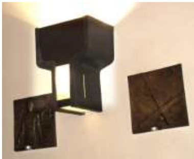
Fig. 65. Applique lumineuse installée lors des travaux de 1980 (photo Bruno Corthésy, 2013).
