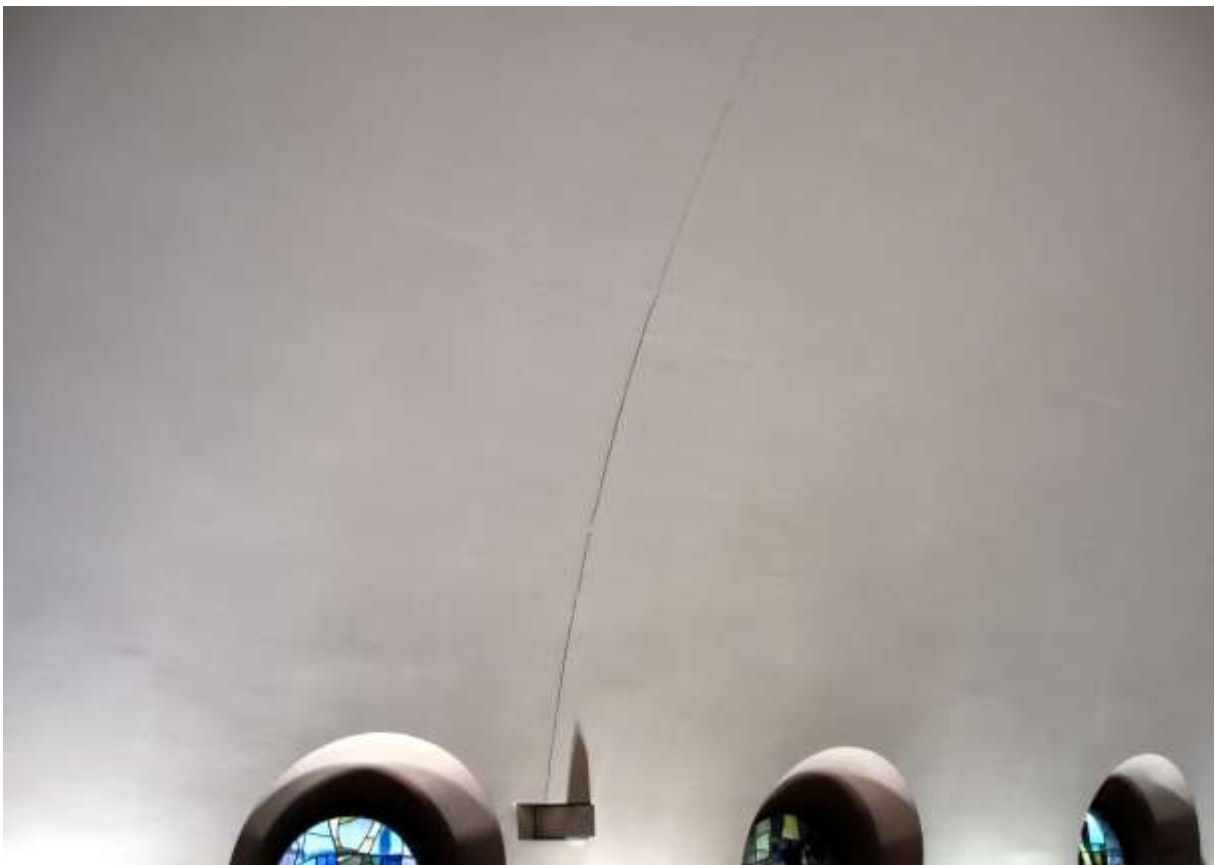
Fig. 76. Fissure sur le mur intérieur Ouest (photo Bruno Corthésy, 2013).
