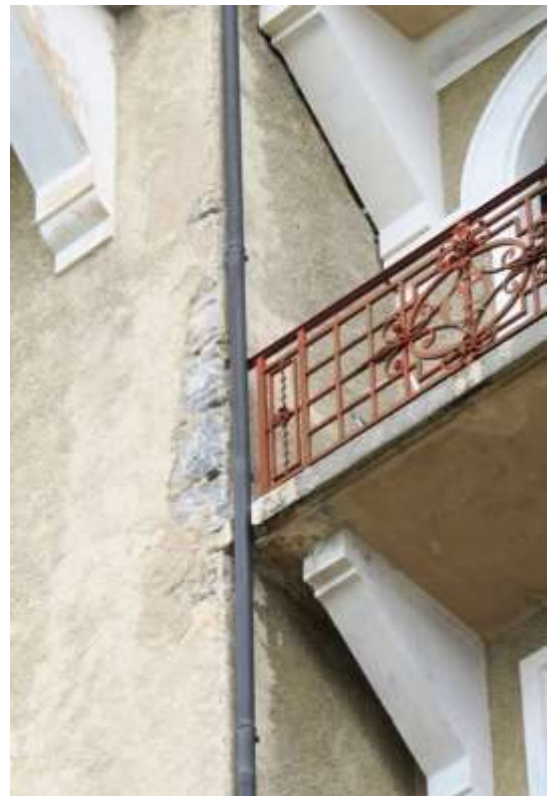
Fig. 46. Façade à l'extrémité ouest de l'aile ouest, détail de dégradation.
