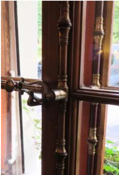
Fig. 84. Réception, serrurerie des fenêtres.
