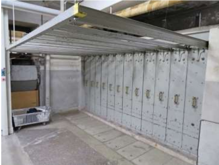
Fig. 28. Rez-de-chaussée, séchoir pour le linge de literie et monte-charge.
